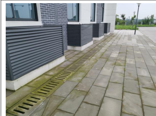
方洞收费管理站站内排水
